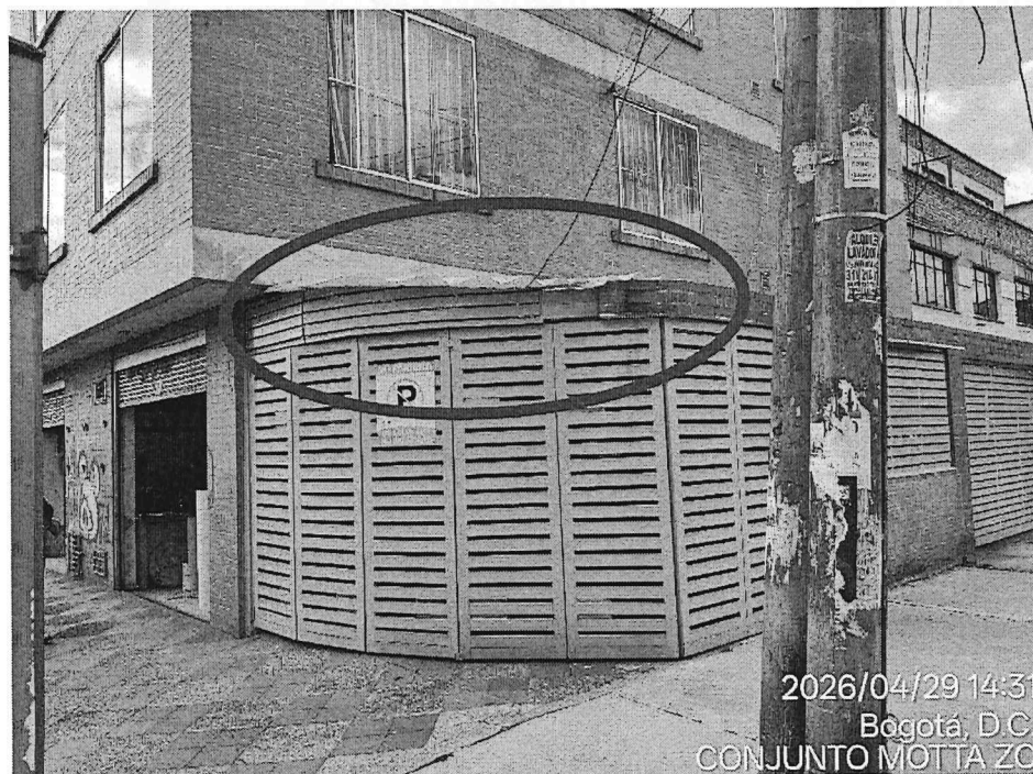
imagen 1 curva en el cerramiento Punto d.
