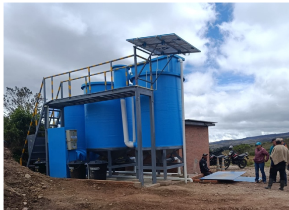
Ilustración 9. Planta compacta de potabilización Instalada – Asoaguas Claras Sumpaz
